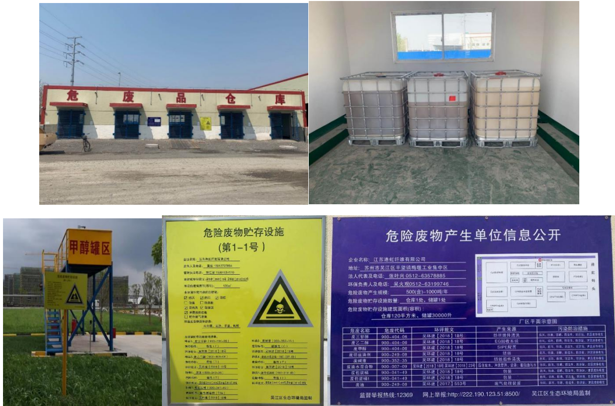
图 3.1-7 厂区危废贮存设施现场照片
